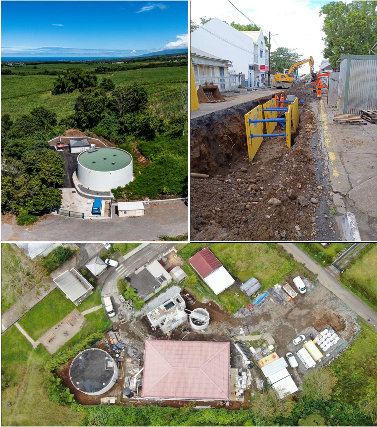
Figure 1 : Forage le Désert, Travaux de renouvellement AEP Avenue de Bourbon, UPEP de Bras Des Calumets,
